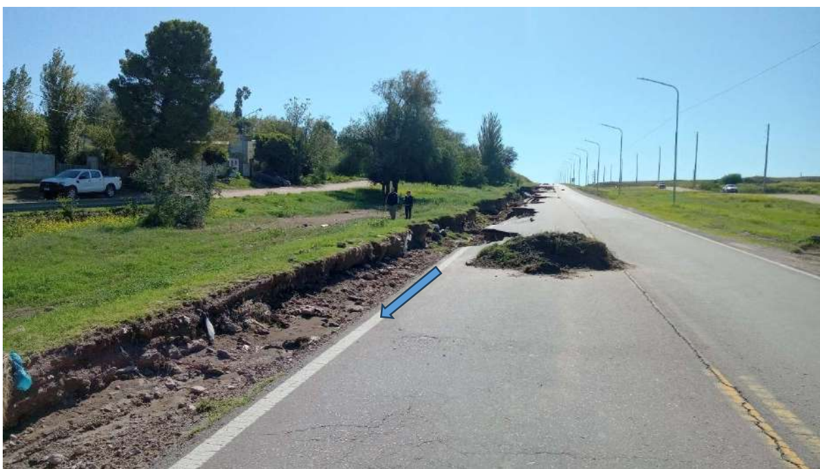
Foto 9 a 17. Daños de socavamiento en calles de tierra con pendiente y posteriormente sobre Calle colectora Indiada al 2000 y Av. Circunvalación Gral J.M de Rosas en sitios de alta energía erosiva del escurrimiento del agua acumulada en pendientes urbanas. Imágenes identifican puntos de origen de la escorrentía que se podrían abordar con pequeñas obras de reductores de la velocidad del agua.
