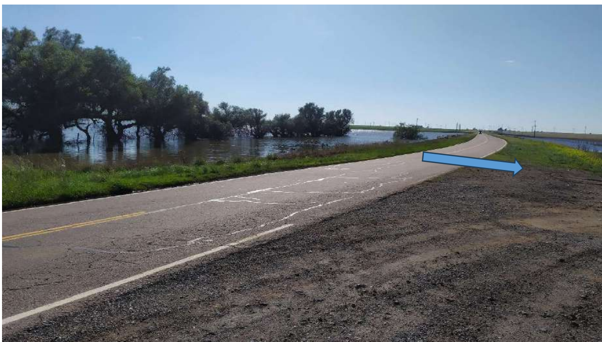
Foto 3. RN 3 pasando el Aeropuerto Cte. Espora, lagunas temporales en zona de bajos frente al Est. Los Mirasoles.
