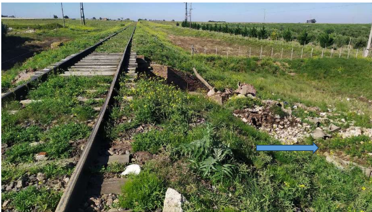
Foto 8. RN 3 tramo viejo desde paso a nivel de la Estación Calderón (Cnel. Rosales), donde se observan signos de escorrentía de canto rodado y escombros en la pendiente sureste.
