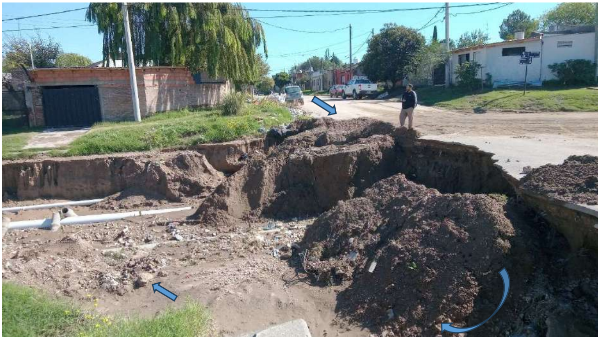
Foto 20 a 23. Daños de socavamiento hasta la profundidad de red cloacal, agua y gas desde calles de tierra con pendiente hacia colectora Indiada y Av. Circunvalación Gral. J.M de Rosas.
