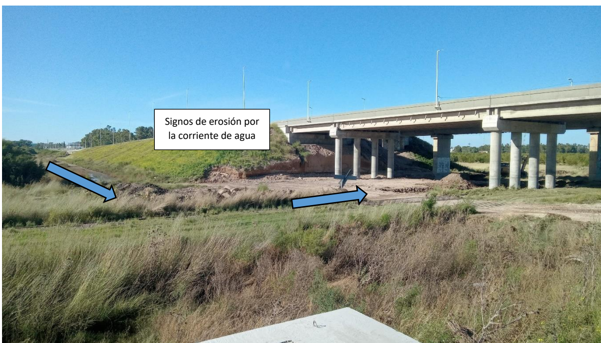
Foto 16. Puente de la autovía sobre camino de la Carrindanga por donde ingreso una gran parte del escurrimiento del sitio 3. Se observan signos de erosión en el terraplén de apoyo este.
