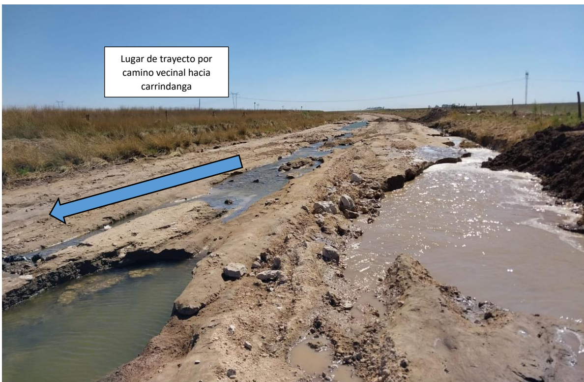
Foto 6. Camino vecinal con signos de socavación profunda en sentido de la intersección con camino de la Carrindanga.
