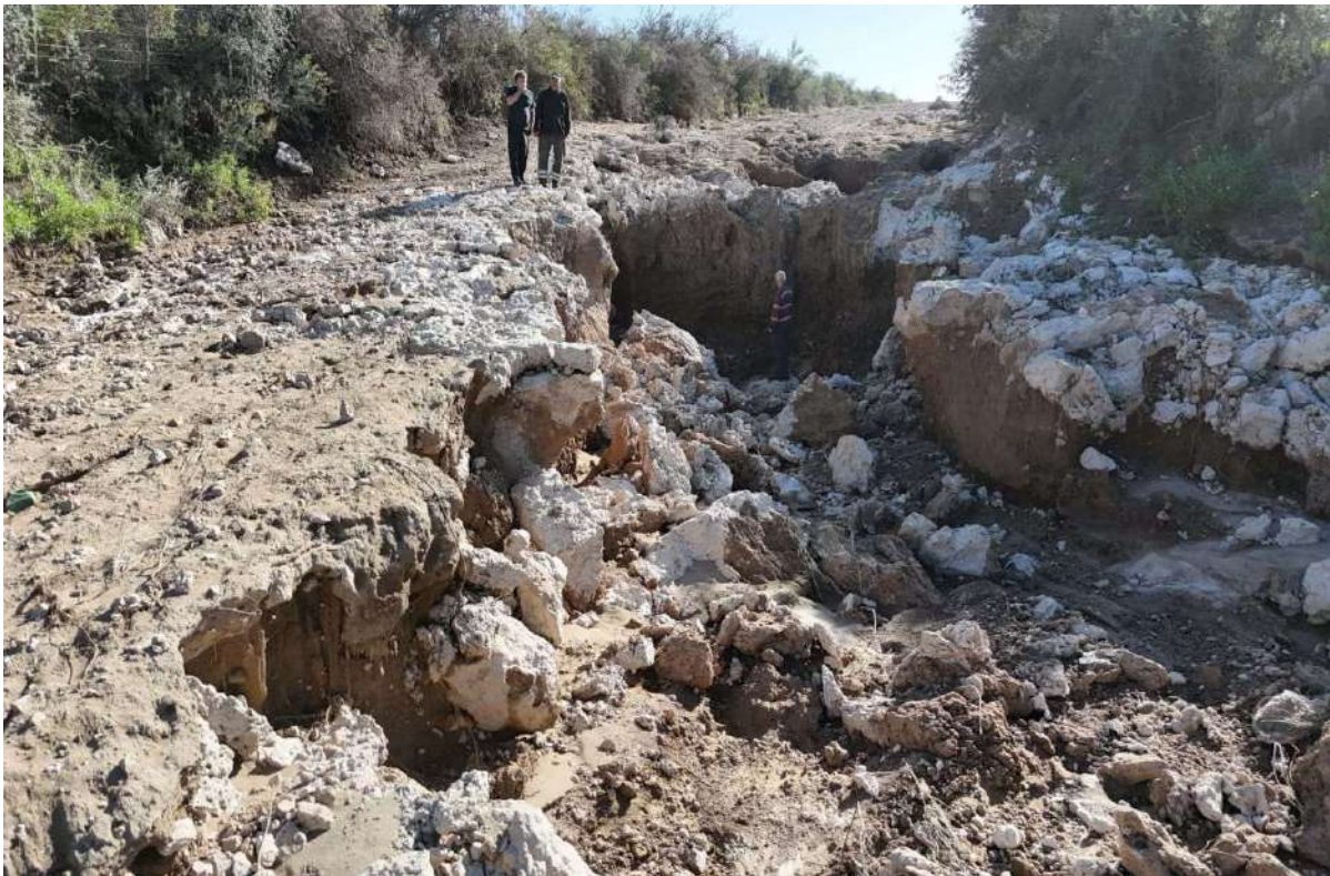
Foto 62 y 63. Escorrentía en Camino Est. La Castellana próxima al cruce RN 3 sur km 712. Gentileza Ing. Florencia Dalmaso.
