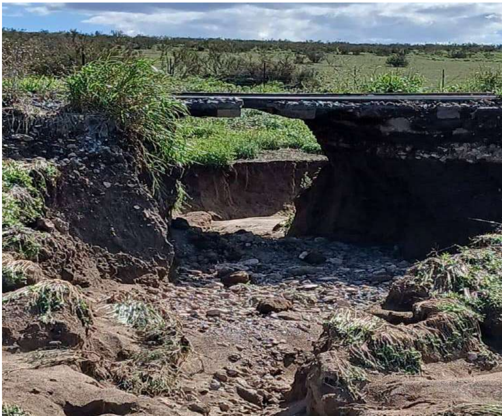
Foto 44 y 45. Daños sobre vías del ferrocarril, paraje Paraje Las Quintas. Gentileza R. Gianotti.
